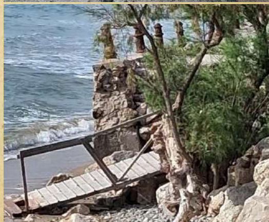
Οι κατασκευές τοίχων από οπλισμένο σκυρόδεμα έχουν υποστεί μεγάλη καθίζηση και επικίνδυνη κλίση (παραλιακός δρόμος)
